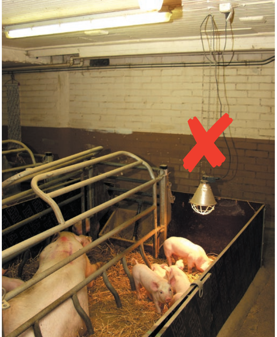
▲ Lämpölamput muodostavat emakkosikaloissa ison paloriskin. Putoamisvaara pienenee tukevalla kiinnityksellä. Palovaara pienenee, kun lamppu on kiinnitetty siten, että pudotus irrottaa johdon pistorasiasta. Lamppujen pinnalle kertyvä pöly lisää palovaaraa.
