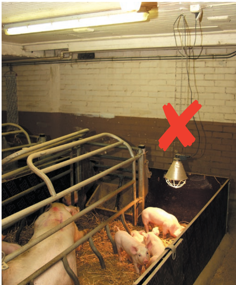
▲ I svingårdar för suggor är värmelampor en stor brandrisk. Om de är ordentligt fästa minskar risken för att de ska falla. Brandrisken kan man minska genom att fästa lampan så att stickkontakten lossnar från eluttaget om lampan eventuellt faller. Damm på lamporna ökar brandfaran.
